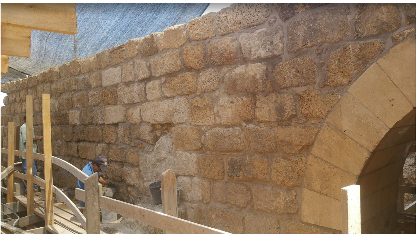
למעלה, בנייה מחדש של אומנה. צילום: רענן כסלו; למטה, ייצוב הקיר באמצעות יישום חומר מליטה במישקים. צילום: יורם סעד
